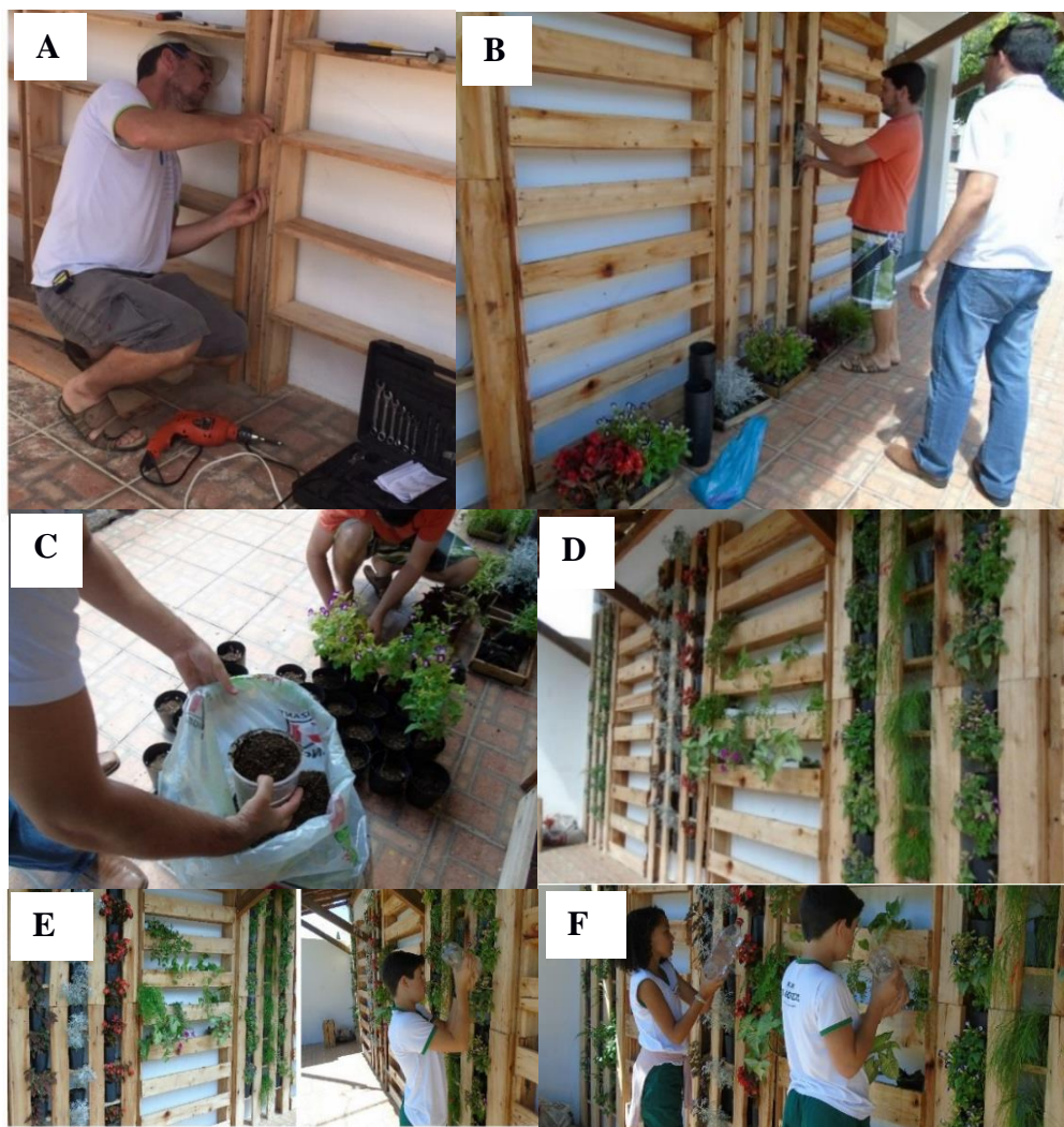
Figura 2 - Etapas da construção do jardim suspenso no espaço da Escola Municipal de Ensino Fundamental Atílio Pizzol. Parceria de pessoas da comunidade e de professores na construção (A, B) e no plantio (C). Estrutura montada e participação dos alunos na manutenção (E, F)
