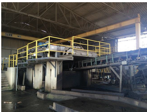
Figura 3 - Centrífugas utilizadas para desidratação do lodo.
